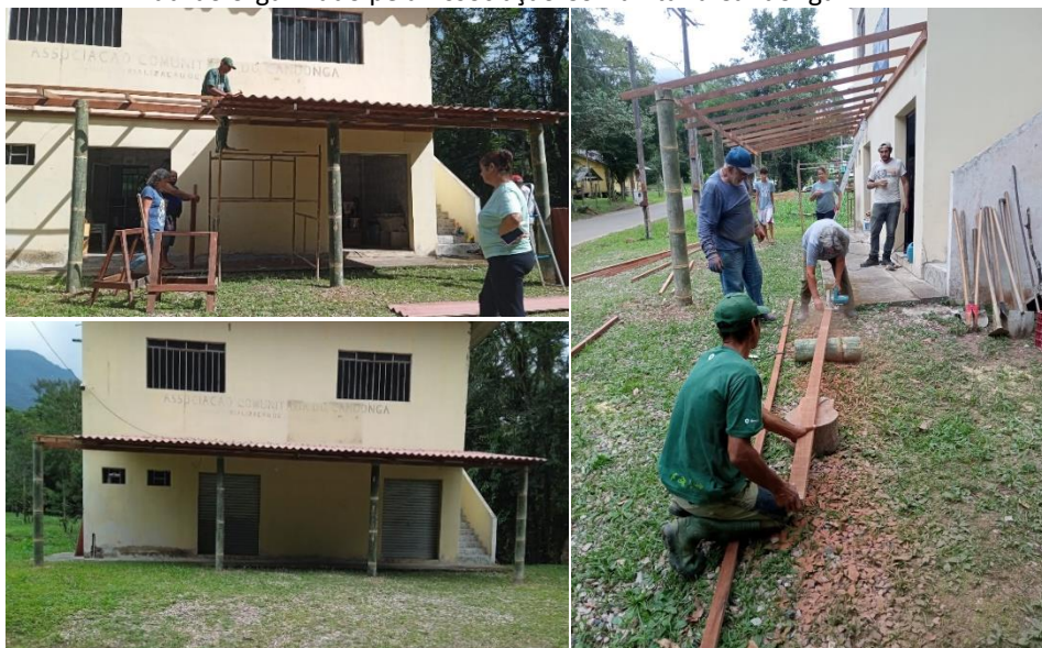
Figura 4- Cobertura da área externa da cozinha comunitária, construída com a ajuda de um mutirão organizado pela Associação Comunitária Candonga.
