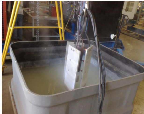
Figura 1 – Cuba eletrolítica – dispositivo resistivo utilizado para dissipação de energia elétrica produzida pelo grupo gerador.
