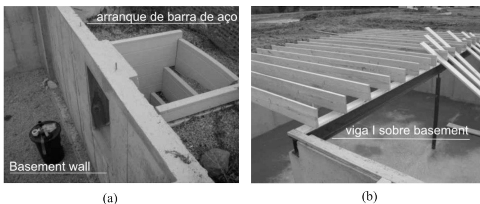
Figura 1. Fundação: (a) Basement wall e arranque de barra de aço para fixação dos painéis; (b) Vigas I sobre o basement wall .
