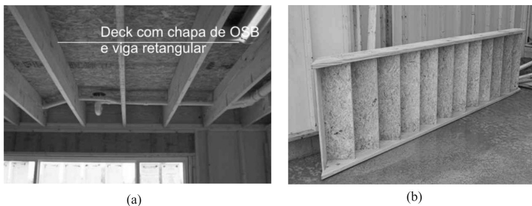
Figura 2. Pisos: (a) Detalhe do deck com chapa de OSB; (b) Detalhe do piso do primeiro pavimento.
