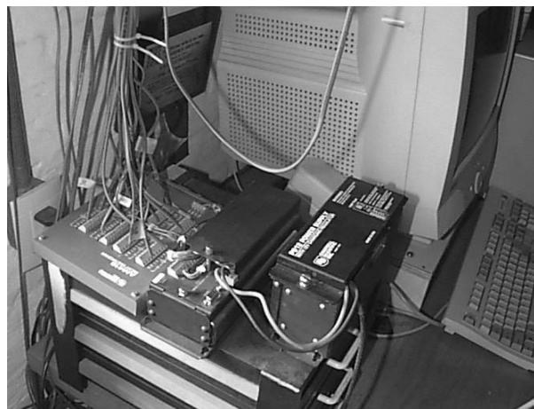
Figura 1. Vista geral do sistema de aquisição automática de dados, composto por datalogger CR10X Campbell Scientific Inc. , com multiplexador de sinais acoplado AM 416 e sistema de bateria e filtros de tensão. Na figura pode-se observar, à esquerda, os cabos axiais azuis que são os termopares tipo T. À direita e ao fundo vista parcial do computador servidor do sistema de aquisição.
