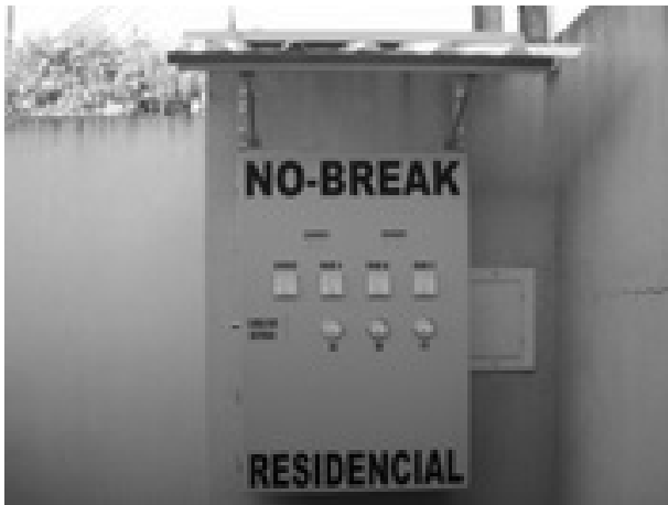
Figura 17 - Fotografia do Protótipo do No-Break instalado.
