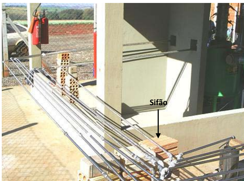
Figura 9. Tubos de saída do biocombustível da mini-usina de craqueamento na Embrapa Soja. Foto: Paulo Felici, 2007.
