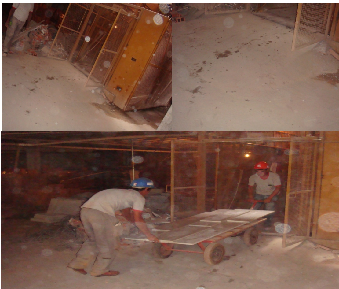
Figura 7 - Cremalheira com rampa de acesso muito acentuada Fonte: própria
