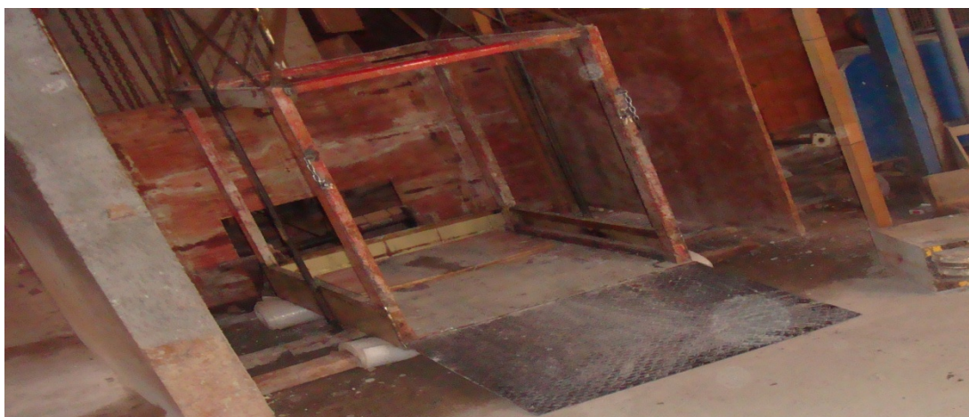
Figura 8 - Elevador de apoio carga/descarga
