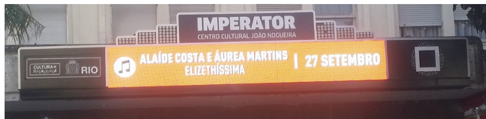
Figura 3 - Fachada com alteração de 2017 e aplicação de símbolo com perda de leitura.
