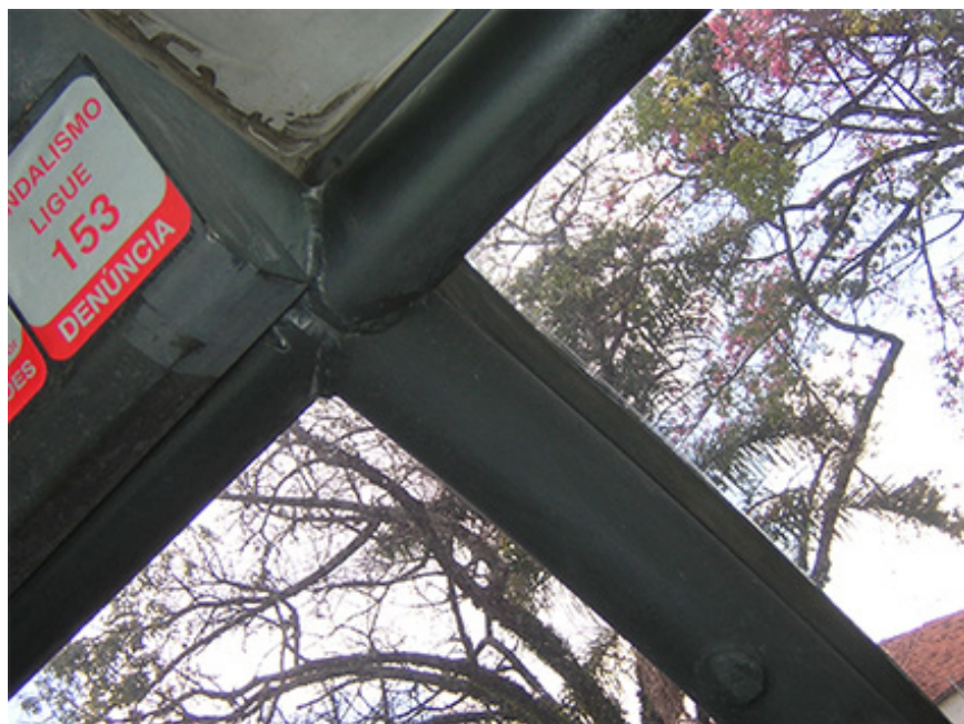
Figura 05 - O ressecamento da borracha ou a oxidação do ferro permitem a formação de goteiras
