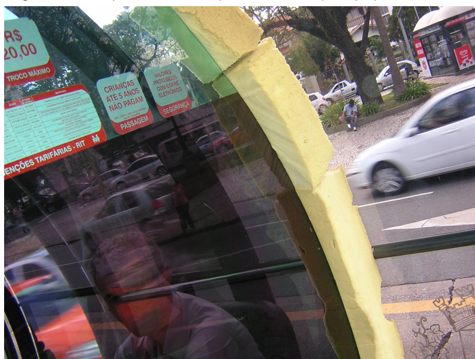
Figura 03- Fresta preenchida com espuma de colchão, pelos próprios cobradores.
