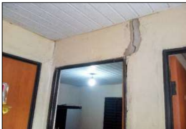
Figura 10 - Condições estruturais das casas
