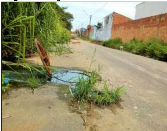
Figura 6 - Esgoto a céu aberto
