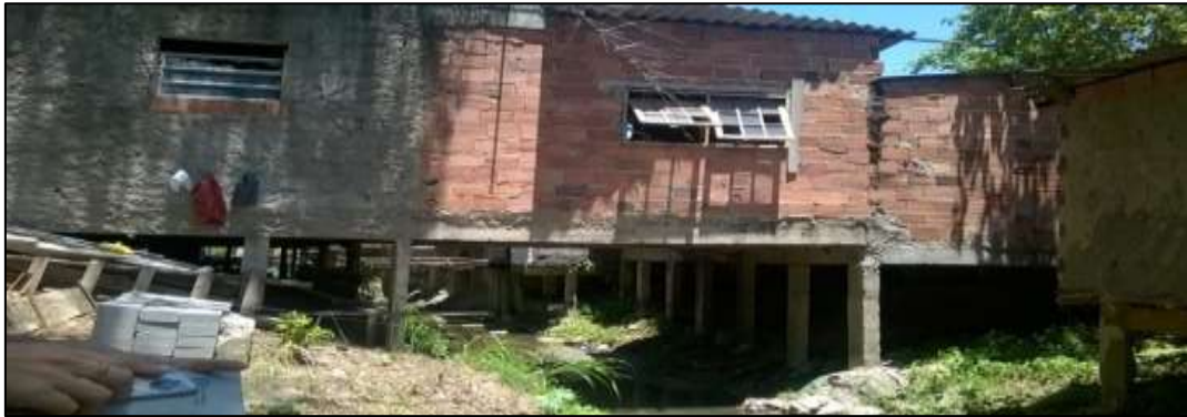
Figura 9 - Casa construída sobre o rio João Mendes inserida no setor censitário de 4 a 10 salários mínimos, ocupando de uma margem a outra
